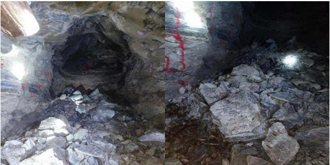
图片 3-1 巷道事故现场照片
