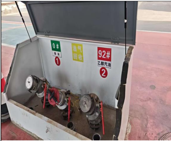
加油站油气回收装置
